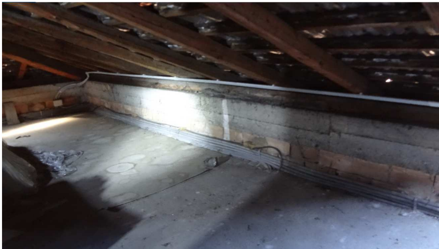
TUBAZIONI IMP. RISCALDAMENTO NELLE PORZIONI DI SOTTOTETTO DI PROPRIETA' DI TERZI E DA DISMETTERE PRIMA DELLA MESSA IN VENDITA
