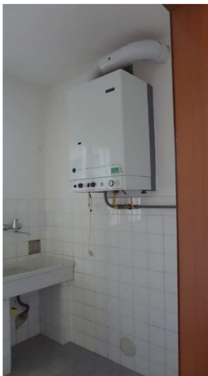
CUCINA E CALDAIA
