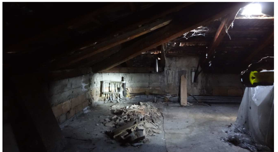
TUBAZIONI E COLLETORE IMP. RISCALDAMENTO NELLE PORZIONI DI SOTTOTETTO DI PROPRIETA' DI TERZI E DA DISMETTERE PRIMA DELLA MESSA IN VENDITA
